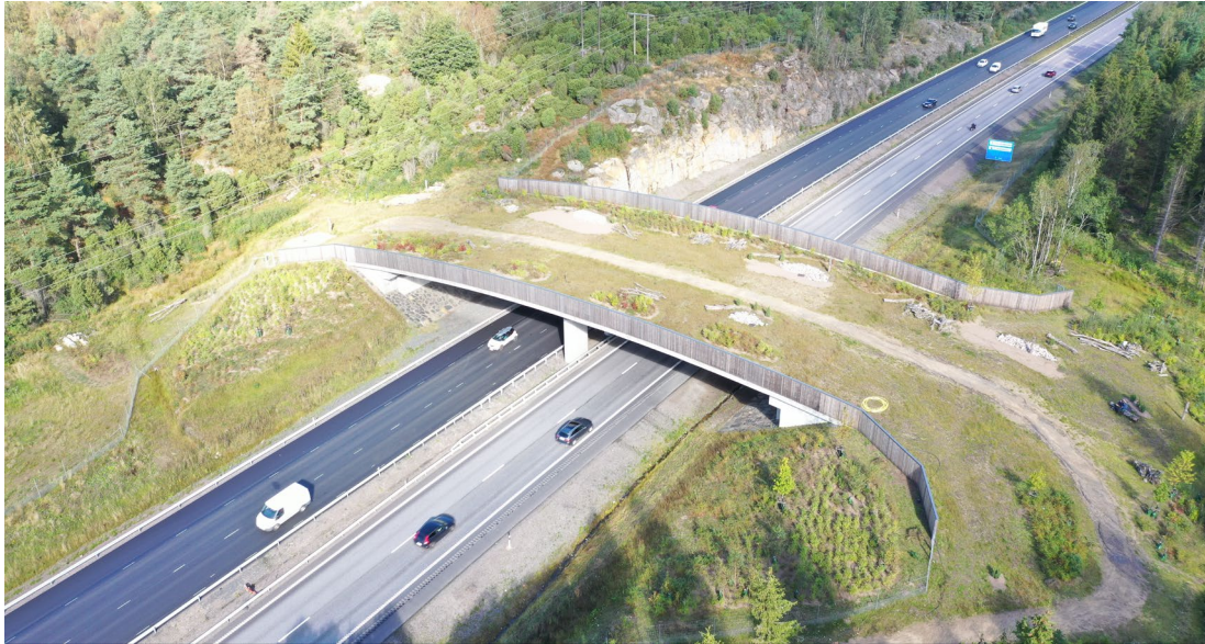
Figur 45. Ekodukt Sandsjöbacka är ett exempel på hur en ekodukt kan visuellt anpassas till omkringliggande landskap. På bilden kan man se hur faunaskärm och kantbalk smälter samman och ansluter till landskapet. Foto: EnviroPlanning, Fredrik Winterås
