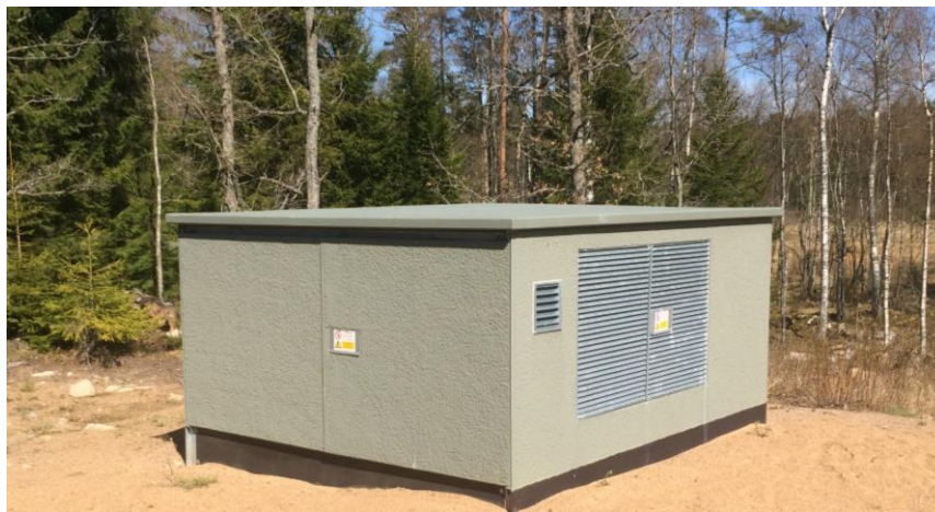
Figur 13. Exempel på hur en fristående transformatorstation vid tornets bas kan se ut.
