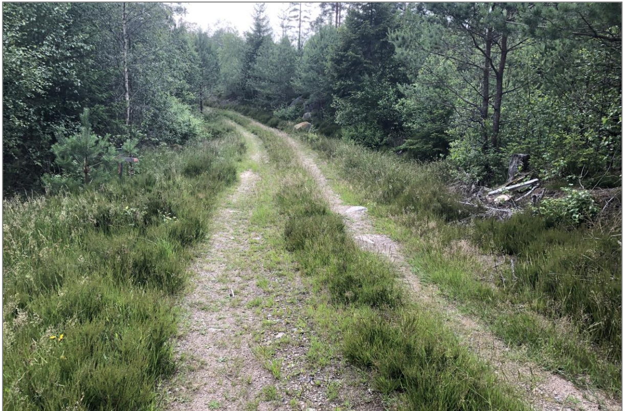
Figur 31. Exempel på väg i behov av förstärkning och breddning.
