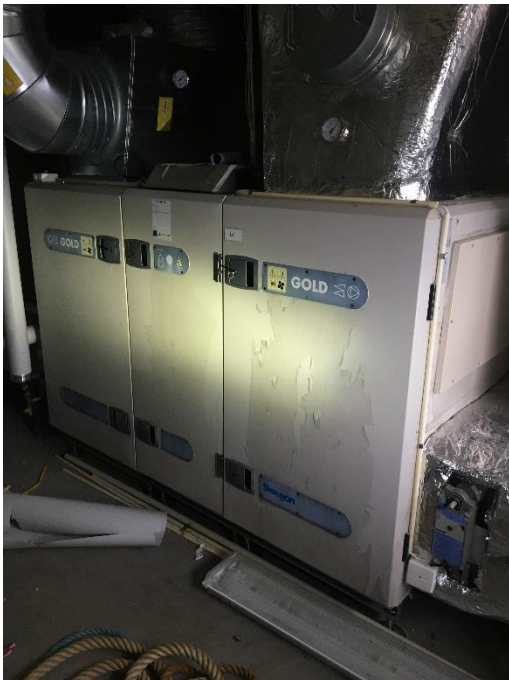
Bild 18: Ventilationsaggregat placerat i anslutning till idrottshall.
