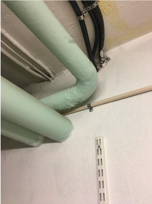
Bild 24: Rörisolering källare Lärosalsbyggnad
