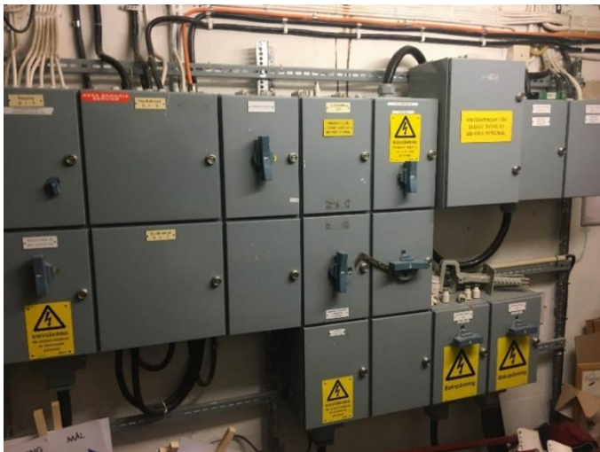
Bild 27: El-central källare Lärsalsbyggnad
