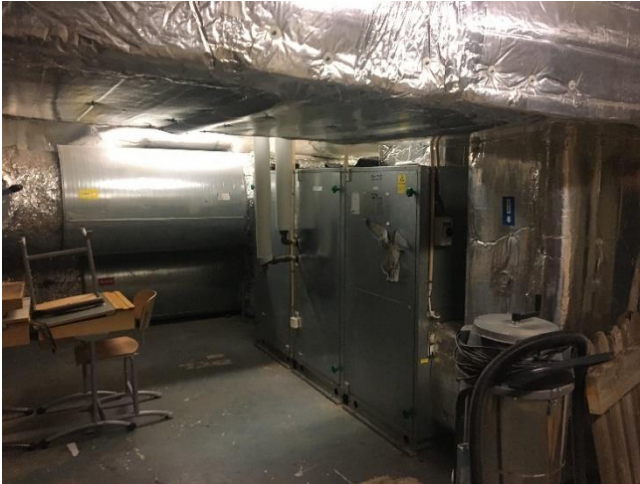
Bild 17: Ventilationsaggregat pplacerat i källare lärosalsbyggnad.
