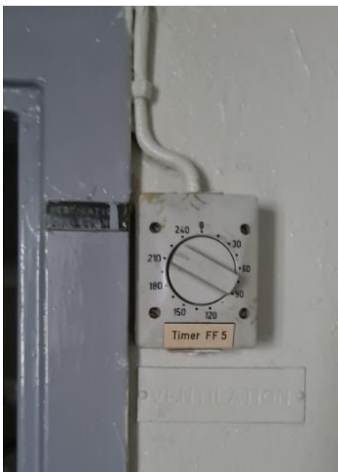
Bild 39, forcering ventilation RC-lokal
