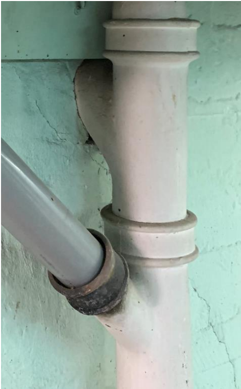
Bild 60, avloppsrör i källare
