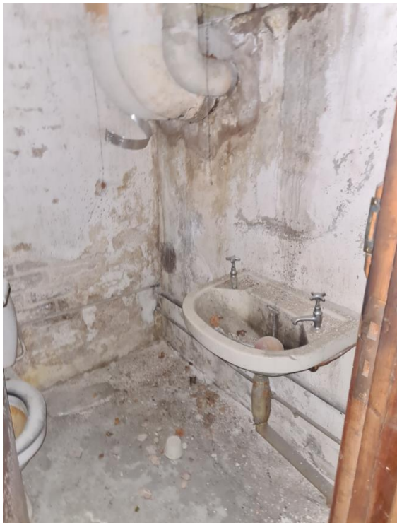
Bild 41, toalett i källare mellan undercentral och fläktrum
