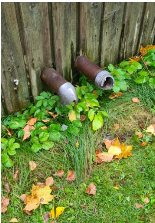
Bild 16, påfyllningsrör från oljetank
