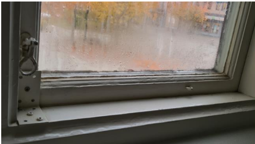
Bild 35, Fukt på fönster
