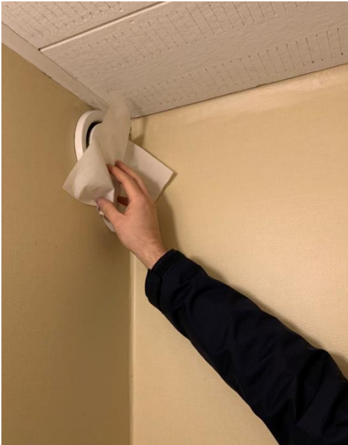
Bild 53, frånluftsdon i toalett
