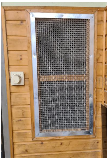
Bild 40, ventilationsgaller i RC lokal
