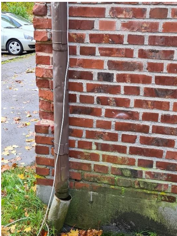
Bild 10, hörn på tillbyggnad.
