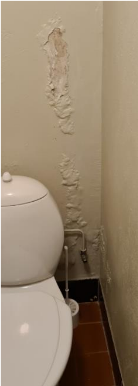
Bild 32. Skada på vägg i toalett i källare
