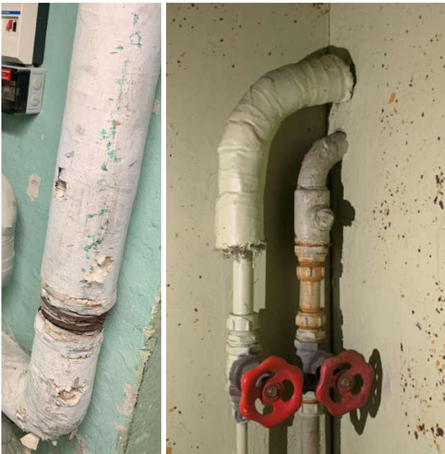
Bild 54, Rörisolering med misstänkt asbest i undercentral m.fl. ställen.
