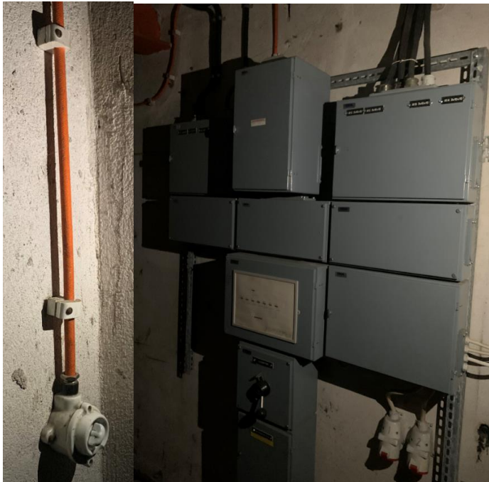
Bild 55, el i källare
