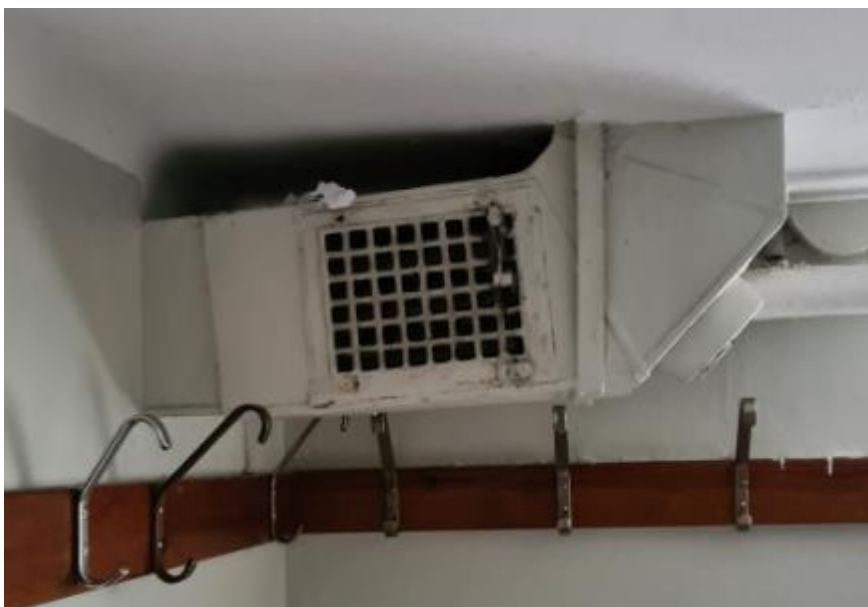
Bild 29. Ventilationsdon i omkl rum
