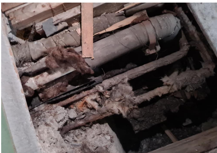
Bild 49, vid tvättställ / tillbyggnad uppbrutet golv.
